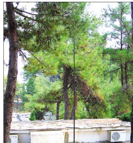
Die 3-Band-Groundplane auf dem Dach des Bungalows Fotos: DF3IS
